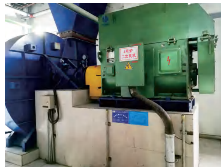
如东协鑫环保热电有限公司变频改造后的4号锅炉二次风机
